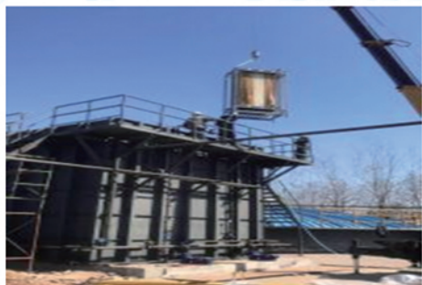
华药MBR加BAF中水回用项目MBR膜采购项目
